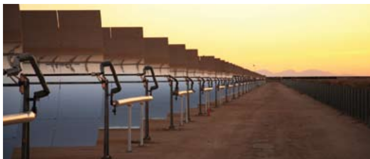
Central energética de colectores solares parabólicos
