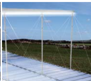
Central de energía solar Fresnel
